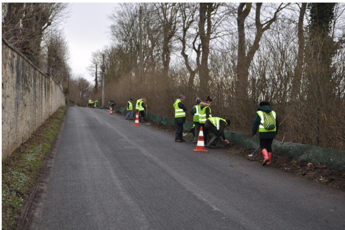
Barrage amphibiens à Etampes (91) © Mr Raveneau
